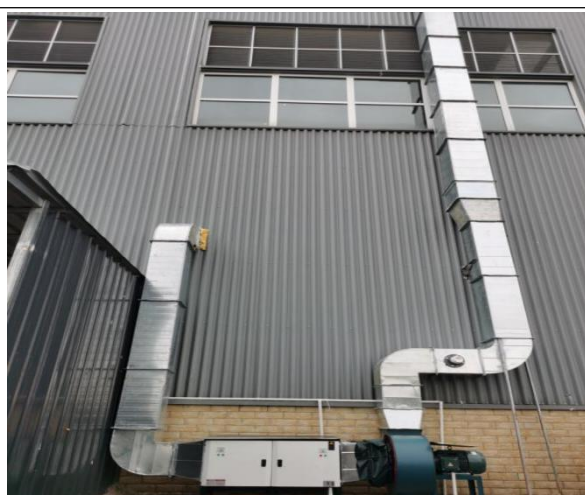
活性炭吸附装置+排气筒
