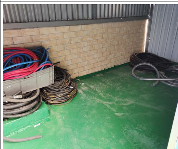
危废间防渗漆
